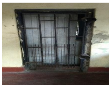
Rotten wooden door
